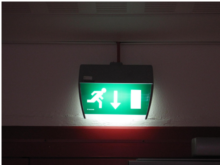
Kuva 1 (Poistumissuuntaa osoittava merkkivalo)
