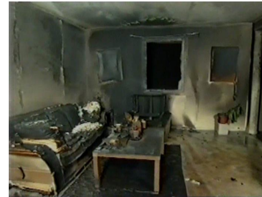
huone palon sammuttamisen jälkeen
